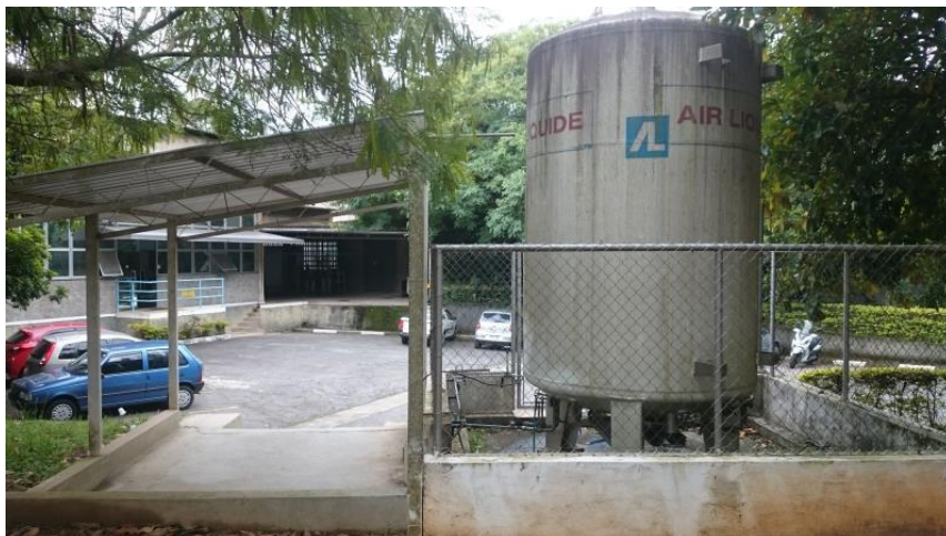
Figura 2: Tanque estacionário com capacidade máxima de 6.000 m 3
