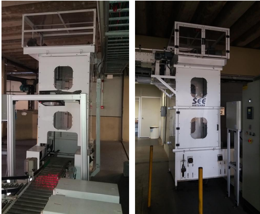
Figura 3: Plataforma Elevatória Externa
